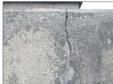
<ひび割れ状況>
