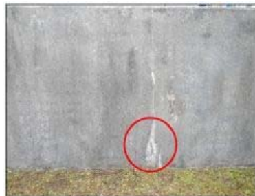
<ひび割れ・エフロレッセンス状況>
