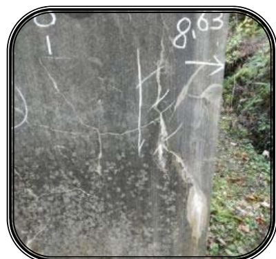
【写真 劣化調査(平野配水池)】
