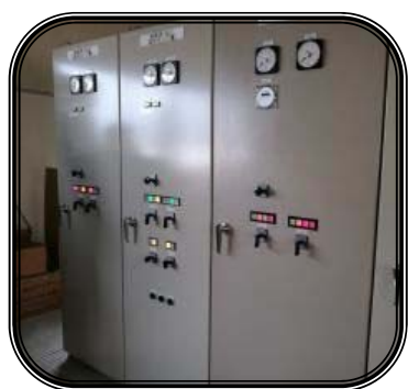
【写真 電気施設(計装盤)】
