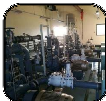
【写真 機械施設(ポンプ)】
