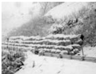
侵入路のり面崩壊により通行止
