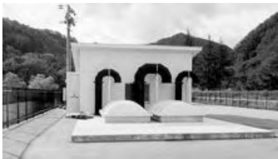
野川小水力発電所
