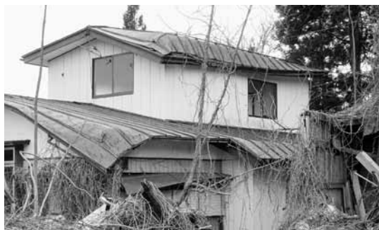
対応が急がれる空き家対策
