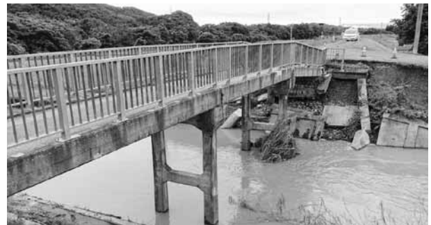
橋脚の周辺が崩れる被害（泉地内福田川）
