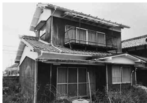
危険空き家対策は待ったなしの状況（イメージ）
