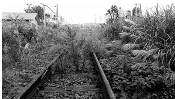
米坂線の現状（時庭地内）
