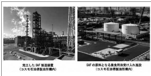
完工した SAF 製造装置（コスモ石油 HP より）
