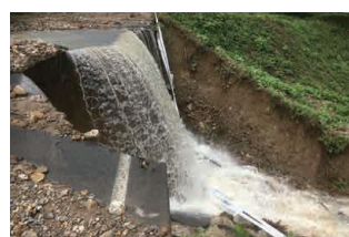
▲鴨石沢の路盤崩落
